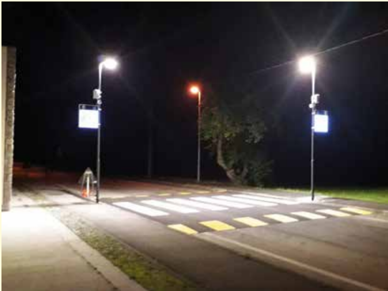
Esempio di illuminazione notturna per attraversamento pedonale sec. UNI-TS 11726 (loc. Mas di Sedico (BL))
